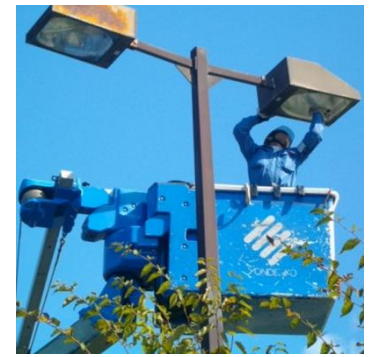
「陶街道ゆとり公園」 駐車場の照明器具 の清掃活動
