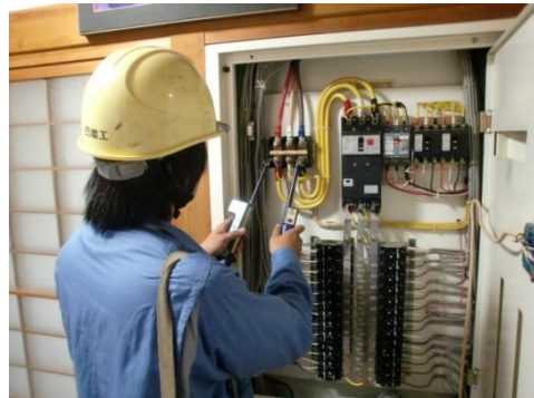
岩本寺の電気設備点検
