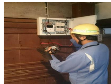
中讃西営業所 金比羅宮の電気設備点検
