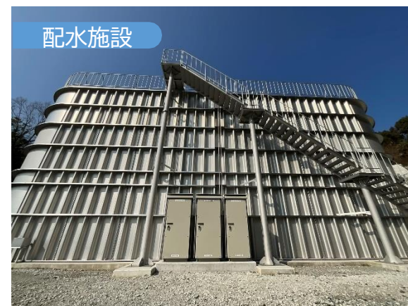
八幡浜市愛宕第4配水池電気計装設備
