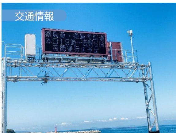
道路情報表示設備
