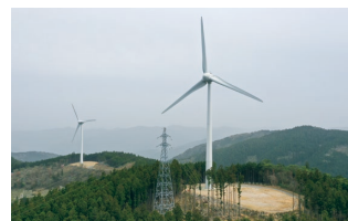
ユーラス上勝山ウインドファーム（徳島県） 風力発電所 [送電工事]
