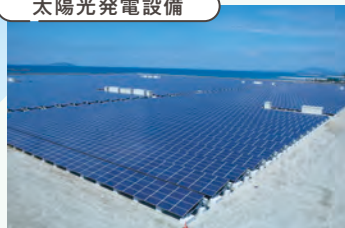
太陽光発電設備
